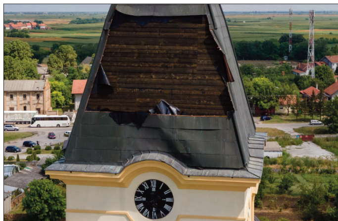
Оштећење на кули торња цркве на Тргу
